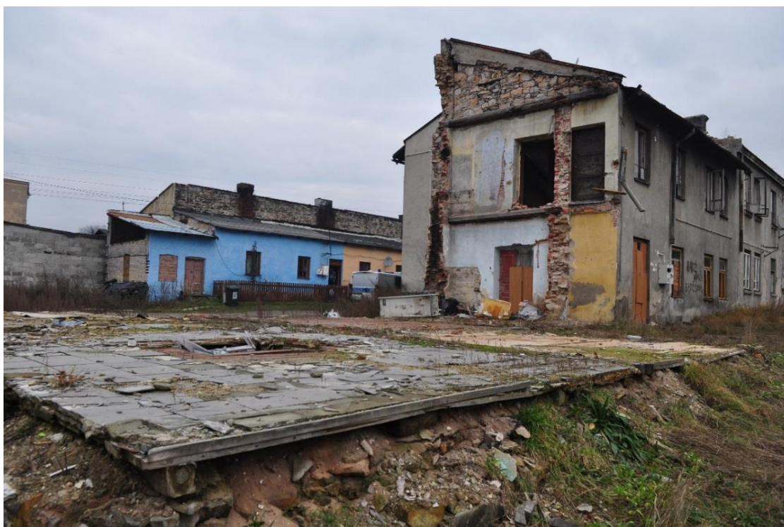
Ryc. 36. Niszczące budynki na Wierzbniku
